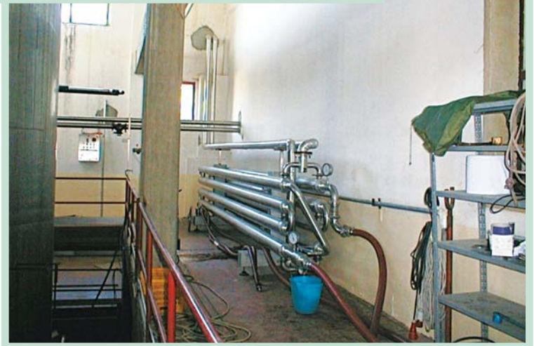
Abb. 65: Technische Ausrüstung für Kühlung und Erhitzung –Röhrenwärme-tauscher
